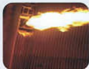
冷炉点火照片
