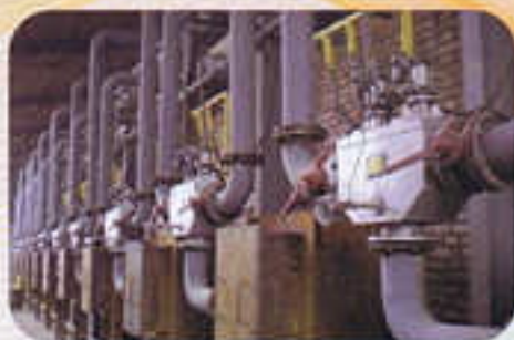
蓄热式燃烧系统
