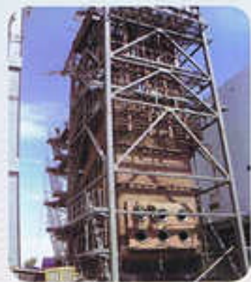
75吨废油尾气锅炉燃烧系统总包
