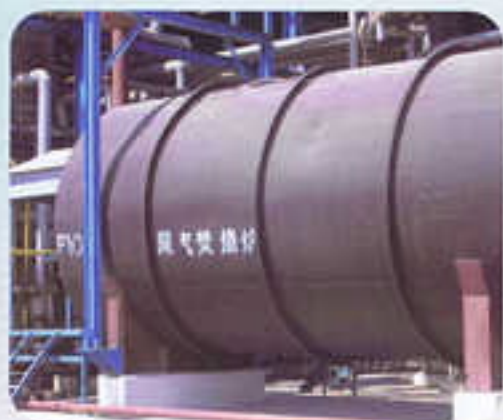
硫磺尾气焚烧炉
