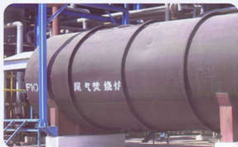
硫磺尾气焚烧炉
